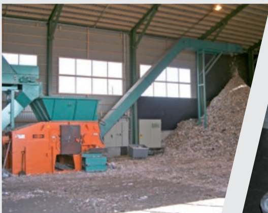
Broyeur ZENO pour le combustible de substitution
