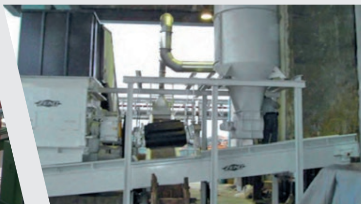
Traitement du combustible de substitution ZENO
