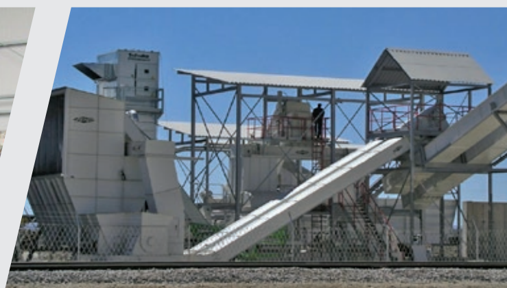
Traitement du combustible de substitution ZENO dans une cimenterie
