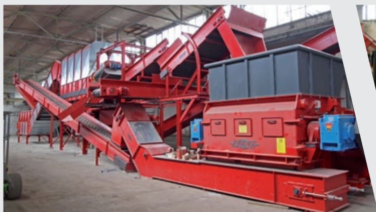
Préparation de matières recyclables ZENO
