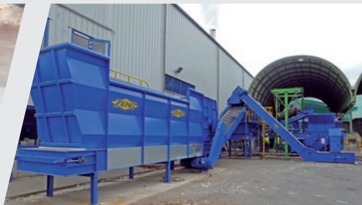
Installation pour le traitement du combustible ZENO pour rejets du textiles
