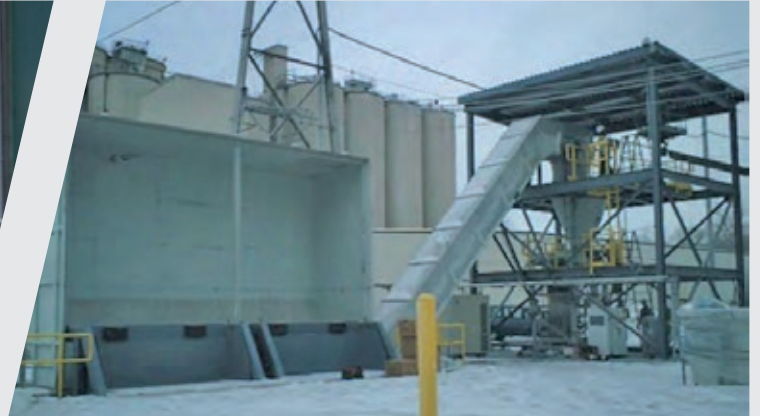
Déchargement et système de dosage ZENO pour l'alimentation d'un secteur
